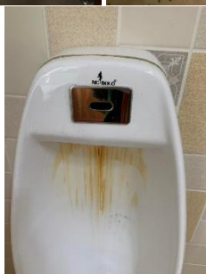
1-р зураг. Суултуур, хөтөвчний ус алдалтаас үүссэн өнгөр, бохирын үлдэгдтэй байдал, шаардлага хангаагүй байдал
